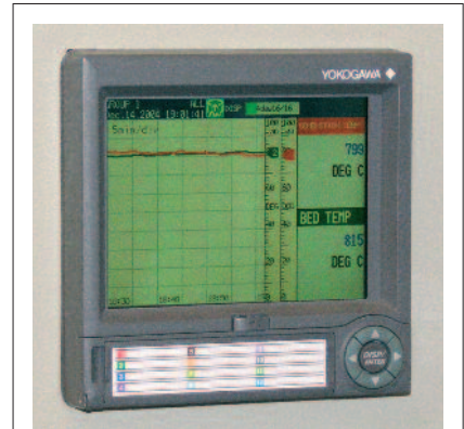
Der Schreiber zeichnet die Temperatur in der Brennkammer der Nachverbrennungsanlage auf, um die CO- und VOC-Oxidation zu dokumentieren. Foto: MEGTEC.
