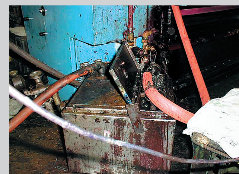
Sobrecarga de un depósito intermedio por mal mantenimiento. Foto: Technotrans.
